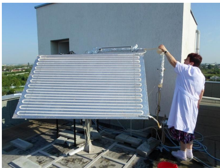
Figura 36. Instalație pilot fotocatalitică solară – reactor solar
